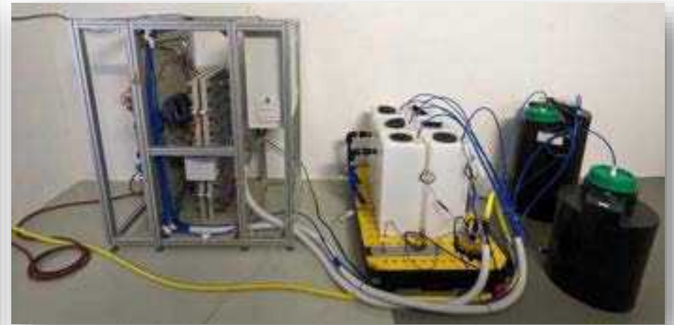
Pilotanlage im Wasserwerk auf Langeoog beim OOWV
