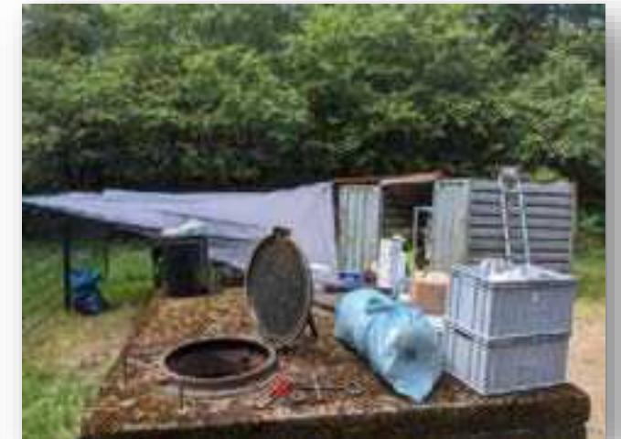
Aufbau der Pilotanlage am Brunnen beim Kreisverband für Wasserwirtschaft in Nienburg
